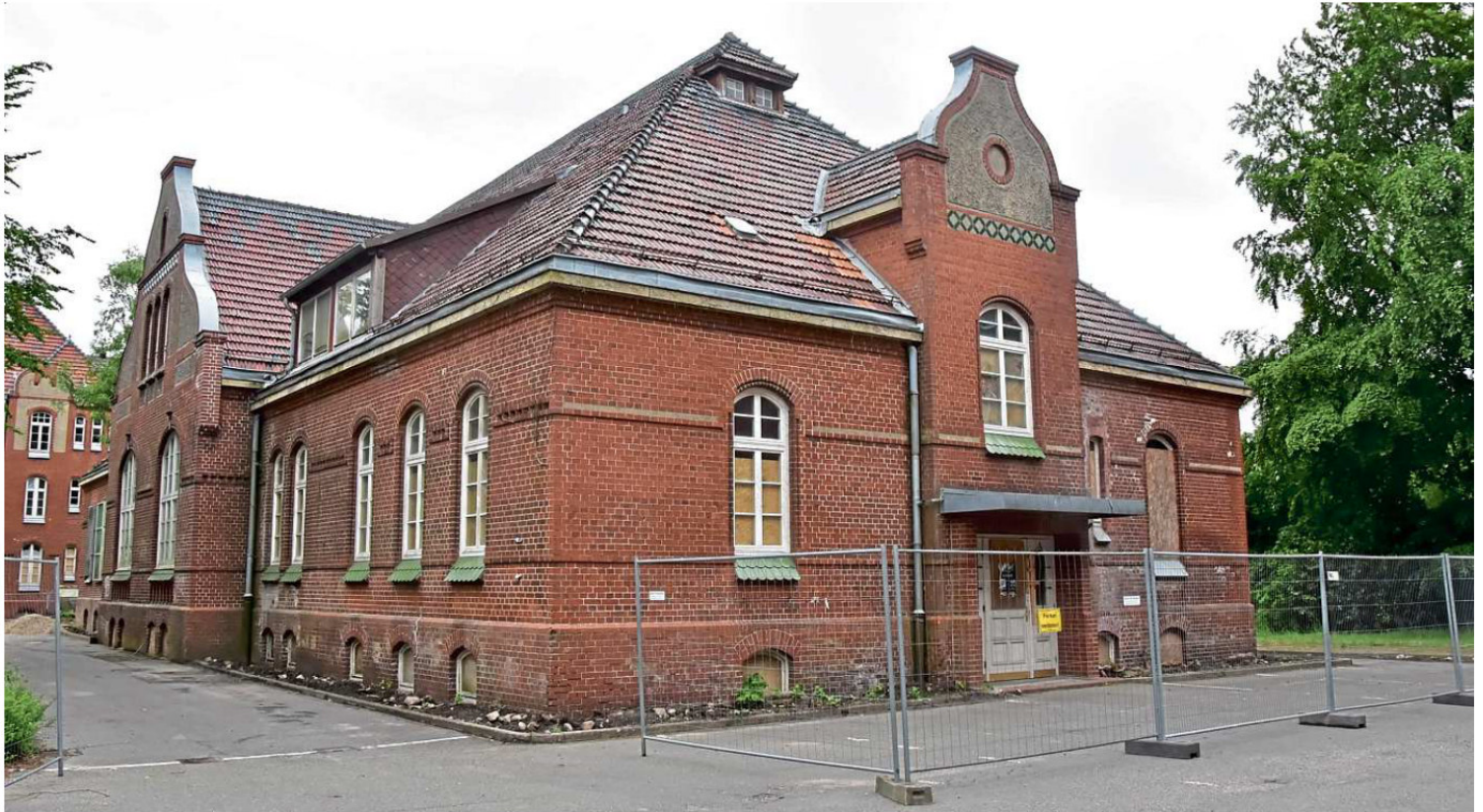
Noch dämmert die alte Eiderkaserne im Dornröschenschlaf. Doch bald soll in die Gebäude neues Leben einziehen.
