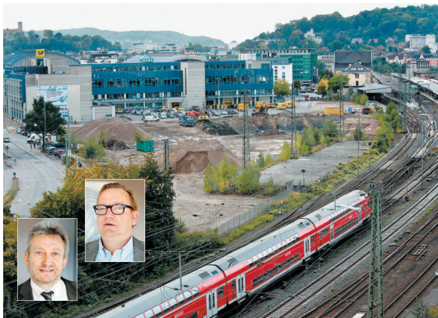
Dreiecksfläche: Hinter der Hauptpost soll das Büro-Viertel „Quartier Nr. 1“ entstehen. Derzeit lässt Investor Sascha Dietrich die Baugrube für das erste Gebäude ausheben. Dort soll das von Geschäftsführer Reiner Radloff (l.) geleitete Jobcenter einziehen. FOTOS: ANDREAS ZÖBE, REIMAR OTT
